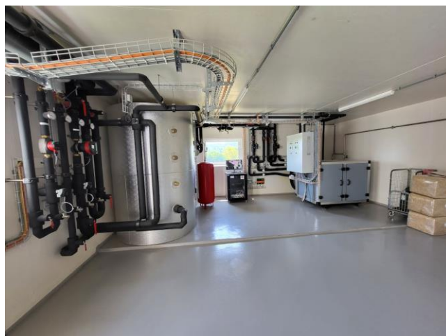
Wärmetauscher im Stallgebäude
