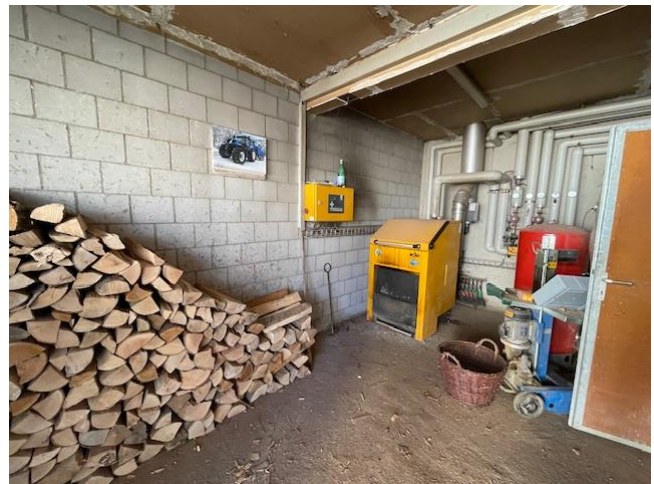
Heizungsraum (EG), Stückholzheizung
